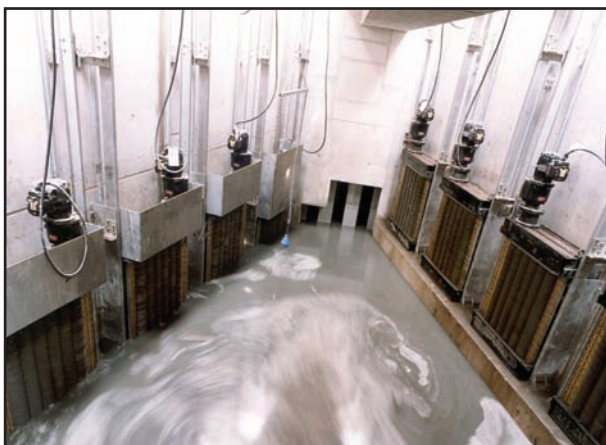
Nueve Discreens instalados en una estación de bombeo de aguas pluviales
