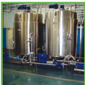
Pompes sanitaires transférant du miel
